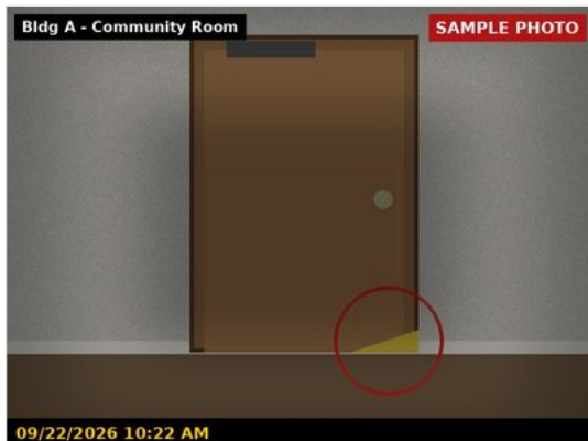
Fire door wedged open
